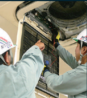
●空調機メンテナンス
